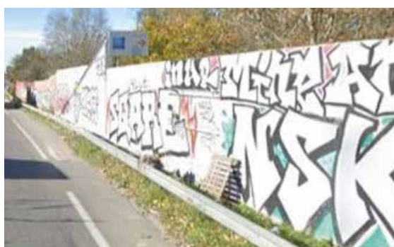
Un dispositif anti-bruit existe le long de la RD113. Il reste toujours efficace dans le cadre du projet.
